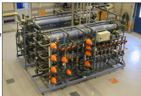
Zweedse drinkwater installatie van 48 m 3 /h. De installatie bestaat uit 2 x NF 03-24, voorfilter en automatische reinigings eenheid. Toepassing: ontharden van grondwater.
